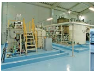
排水処理設備の 防液堤&ライニング
