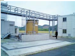
ローリーヤードの 漏洩拡散防止側溝
